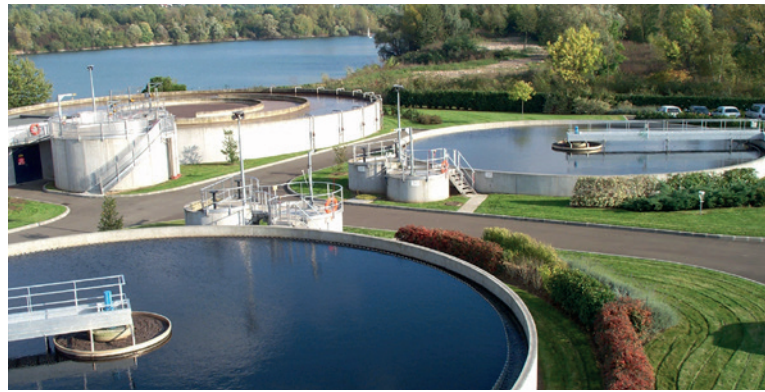
Ci-dessus : Usine de traitement des eaux usées © Droits réservés
