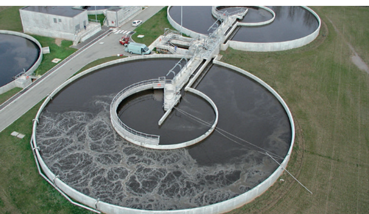
Ci-dessus : Station d'épuration à boues activées © IRSTEA
