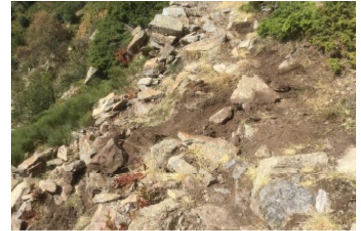
Portion nécessitant une intervention sur l'assise © SMCGS
