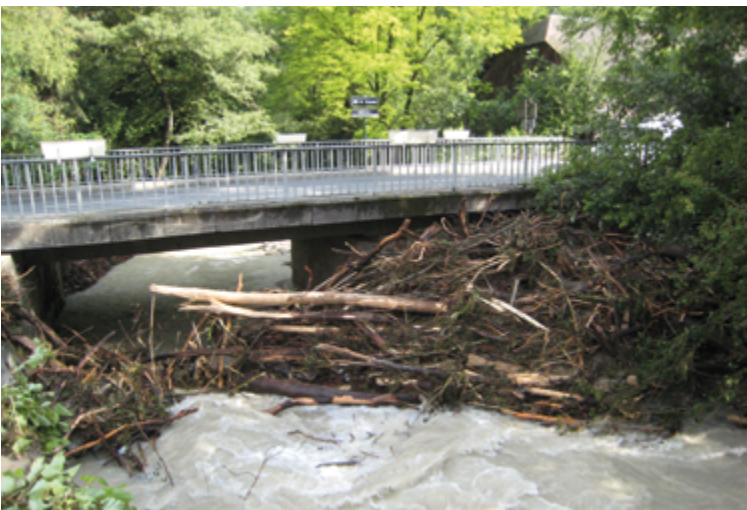
Le blocage des bois flottés a provoqué la submersion de cette route départementale en 2008. En 2018, un tri-bois a été aménagé en amont pour réduire ce risque et éviter d'entretenir de manière préventive la gorge en amont. (©CISALB)
