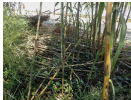
Passage busé obstrué par des cannes de Provence. (©Boyer M./Aquabio)
