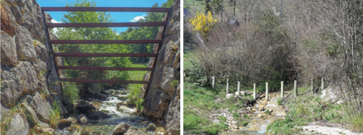
Exemples d'ouvrages de rétention des bois en crue : ouvrage de fermeture d'une plage de dépôts sur un torrent charriant beaucoup de matériaux et tri-bois en amont d'un pont sur un petit cours d'eau. (©Boyer M./Aquabio)
