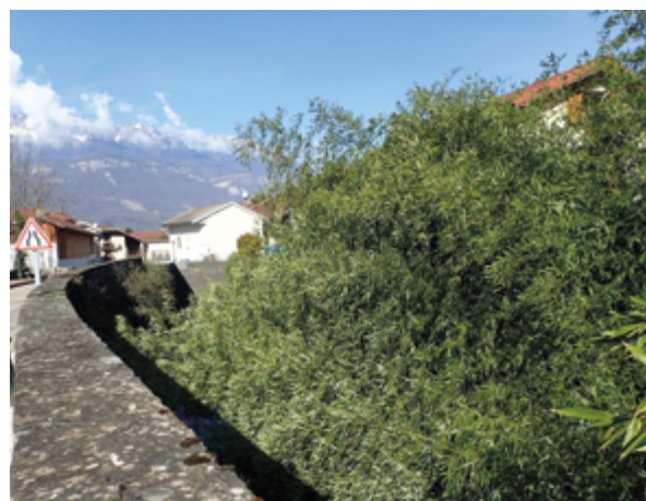
Tout comme les cannes de Provence, les bambous forment des tiges ligneuses très grandes et peuvent fournir brutalement une biomasse importante pouvant obstruer des petits ouvrages. (©Boyer M./Aquabio)
