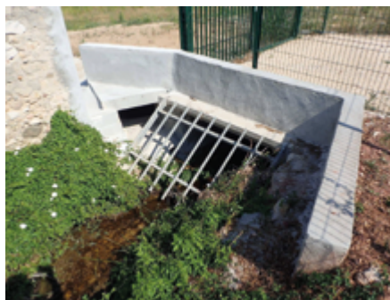
Grille au niveau de l'alimentation d'un bassin d'écrêtement sur un très petit cours d'eau urbain. Le bas de la grille est ouvert pour permettre le passage des flottants transportés en basses eaux et diminuer ainsi l'entretien. (©Boyer M./Aquabio)
