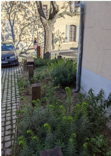
Récupération, des eaux pluviales vers l'espace végétalisé
