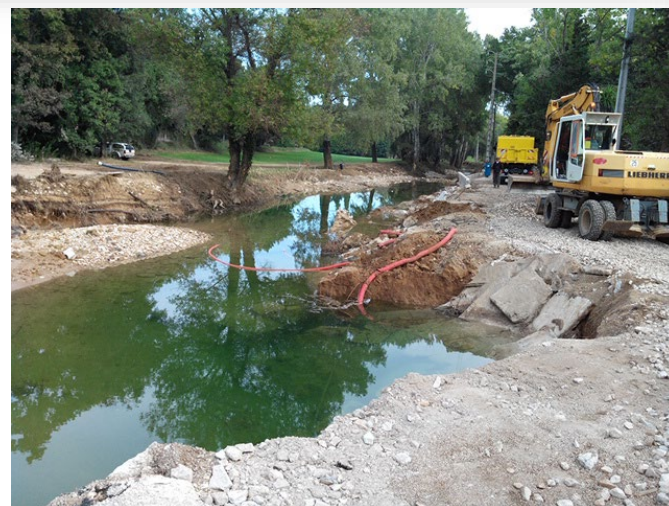
Erosion de berges publiques et
