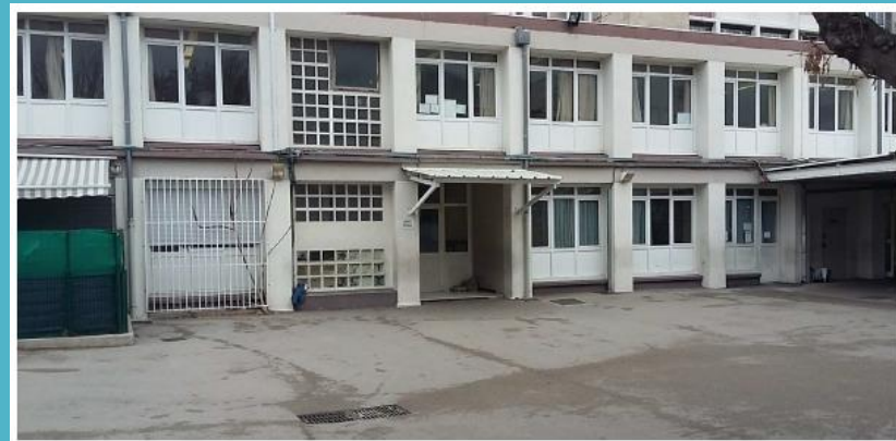
© Région Sud – Ecole Révolution Jet d'eau avant travaux
