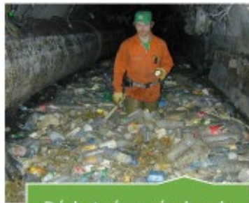
Déchets évacués dans le pluvial
