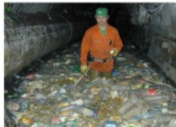
Déchets évacués dans le pluvial
