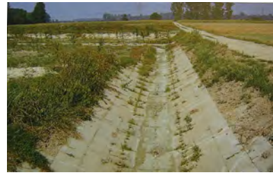
La Sulzbächle, dans la région de la Sarre, vue lors d'un étiage très sec avant restauration.
